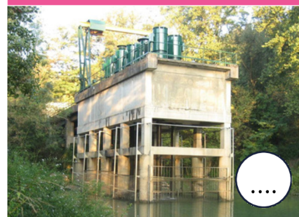
Station de pompage à Millery
